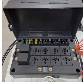
Figura 44 – Caixa de fusíveis.
