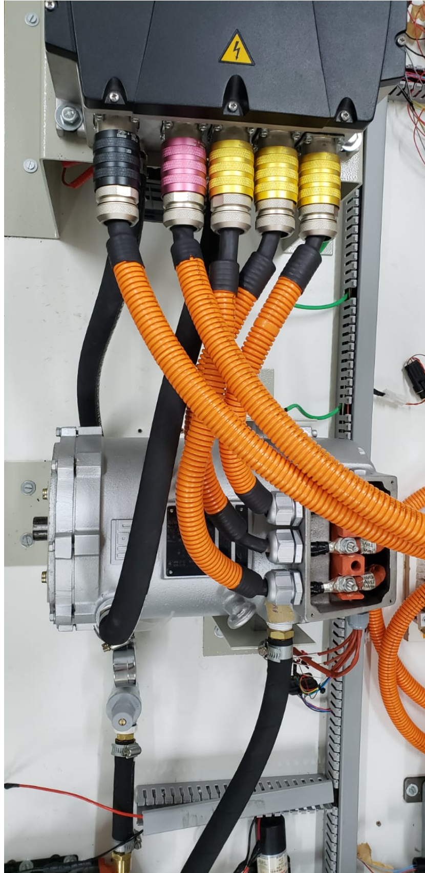
Figura 28 – Conexão inversor-motor com a correção das fases.
