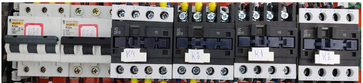
Figura 28 – Disjuntores e contatores implementados para segurança e acionamentos
