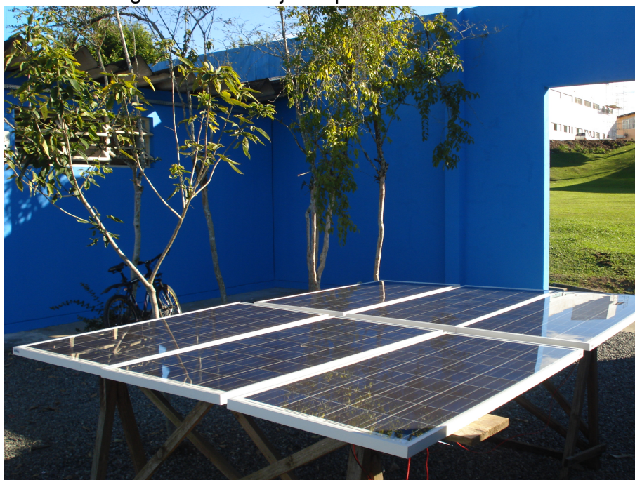
Figura 6.4: Arranjo de painéis fotovoltaicos
